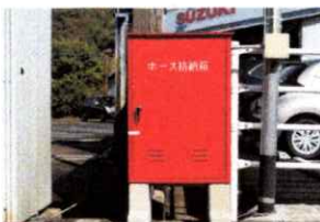
8/29 下夜久野分団の点検を機に、更新された上町自治会の格納箱
